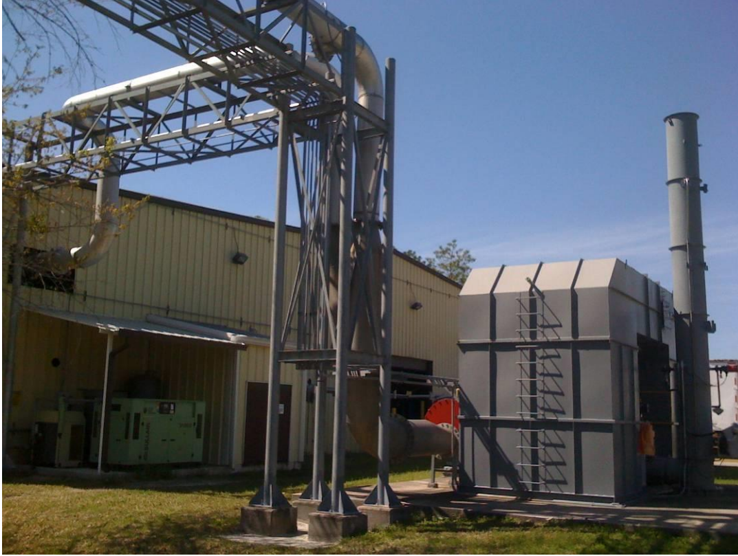
21. Regenerative Thermal Oxidizer (RTO)
