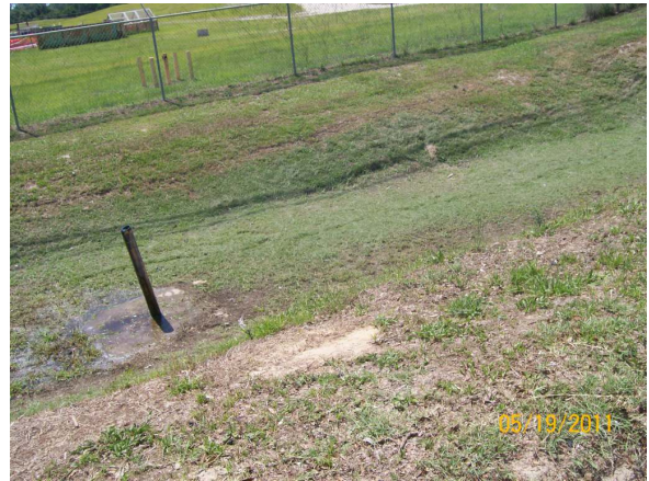
effluent perc pond
