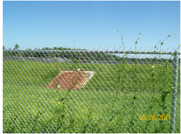
A-4 SW discharge pipe
