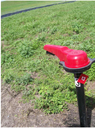
effluent ponds valve "13" label
