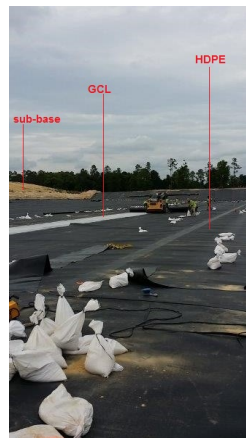
Geomembrane liner system
